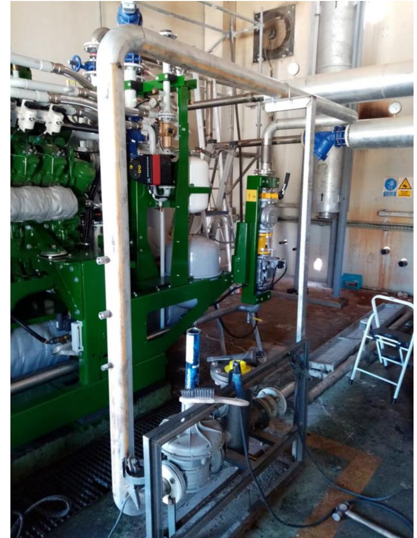
Cogenerador en EDAR Benidorm
