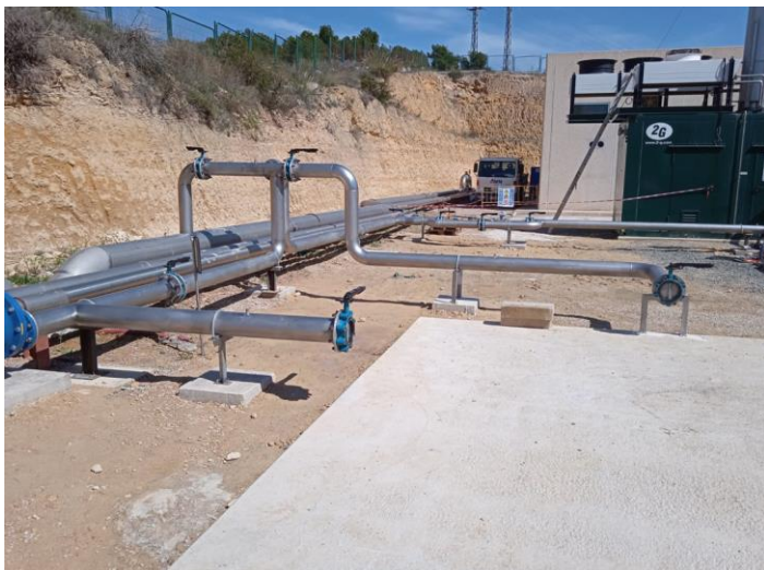
Línea de biogás en EDAR Monte Orgegía
