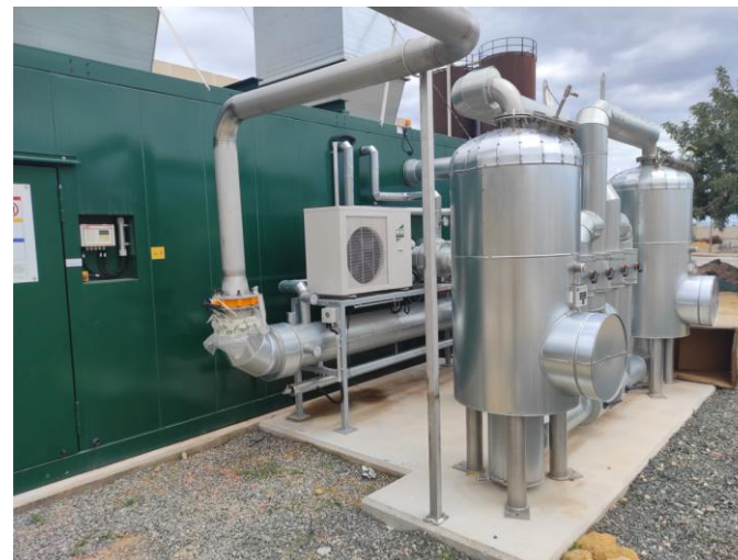
Cogenerador en EDAR Monte Orgegía
